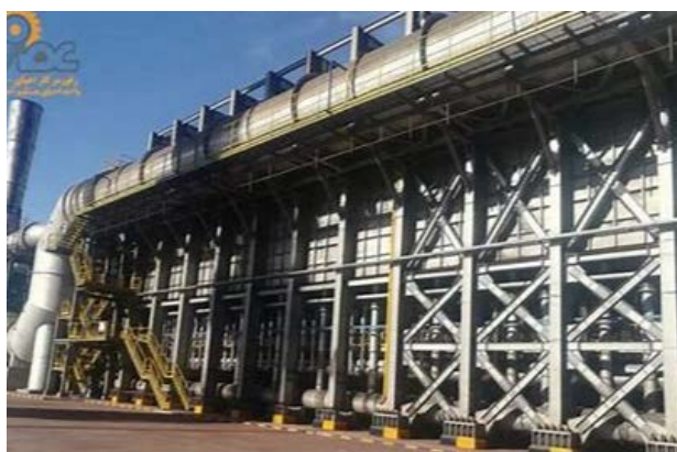
Fig.32 Reformer della Midrex
